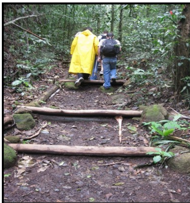
Figura 3 - Os diques construídos para mitigar o alargamento e a erosão perderam substrato e apresenta aprofundamento, isso tem como consequência os problemas de drenagem observados.
