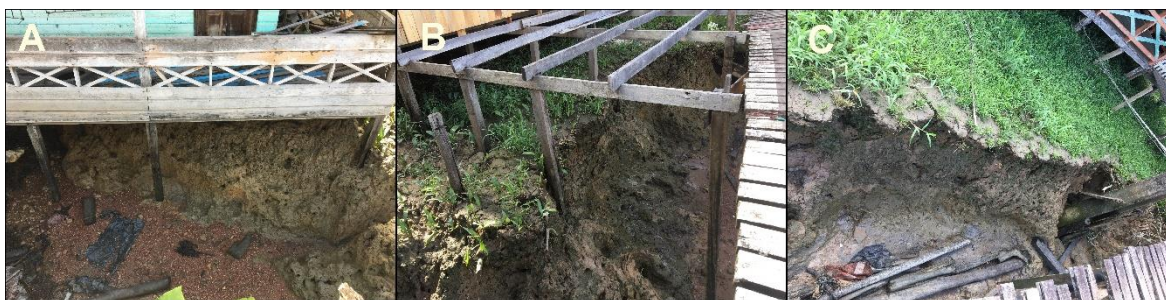
Figura 5 - Processos erosivos na área de proteção ambiental da Fazendinha.
