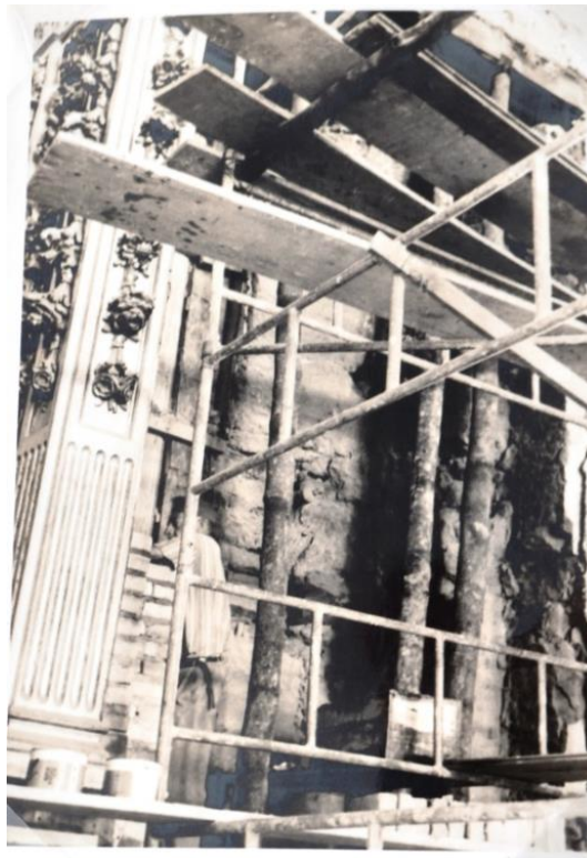
[Fig.5] Escoramento da parede de taipa (com trincas) e início das obras de pilastras de tijolos. Fonte: XAVIER FILHO, Geraldo Francisco. Relatório da restauração do altar de São Miguel na Catedral de Nossa Senhora do Pilar de São João del Rei/Minas Gerais . [ACI-R] / Série CRBC / Caixa s/número]. IPHAN. São João del- Rei, 1970.
