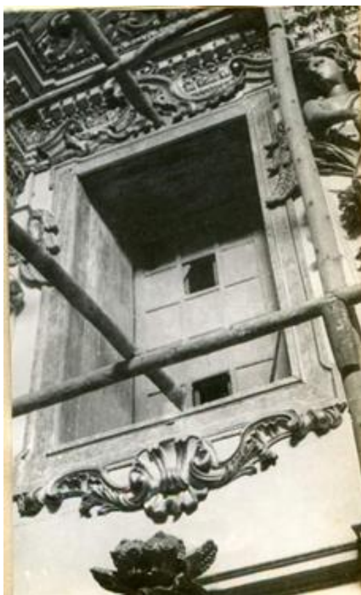
[Fig.4] Janela verdadeira tampada por painel em possível expansão da Igreja com a construção de cômodos laterais. Fonte: MOTTA, Edson. Relatório de conclusão da restauração das obras de pintura e talha da Igreja Matriz de São João del Rei e símula dos trabalhos . [ACI-R]/ Série Arquivo Técnico Administrativo / Subsérie: Restauração de Pintura - cx.004/pasta.20]. DPHAN. Rio de Janeiro, 1958.
